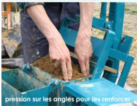
remplissage du bac doseur
